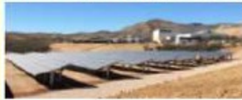
PV Fixed Array 250kW
