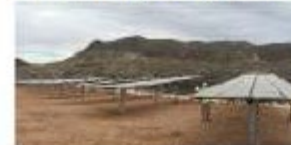
PV Tracking Array 250kW
